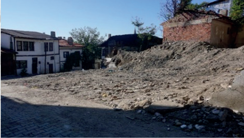
Beytepe Mahallesi 363/6-7-8-9 parselde çıkan yangın sonucu enkazın alınması.
